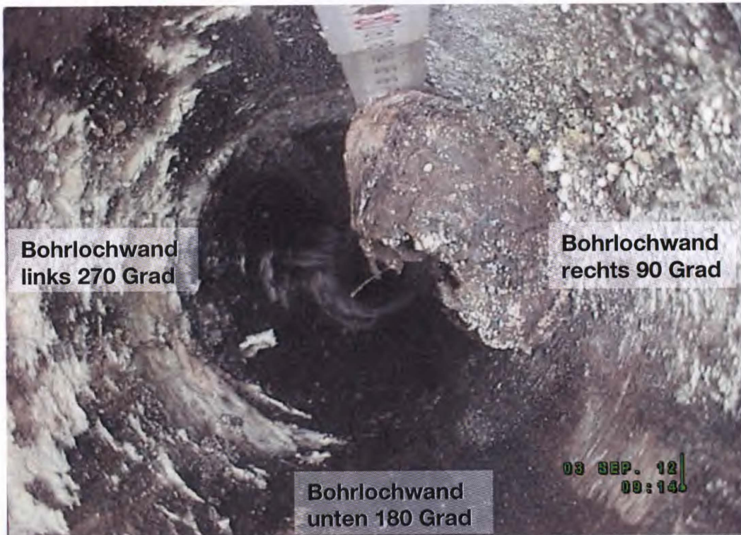
Abbildung 3: Verunreinigung der Bohrlochwand, aufgezeichnet am 03.09.2012 in einer Bohrteufe von 6,80 m.
